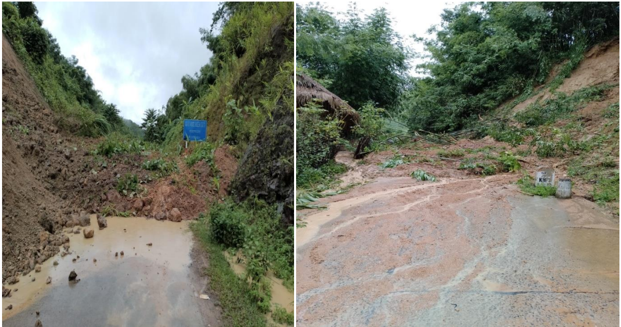
Hình 01: Sạt lở phần taluy dương tại tuyến đường giao thông liên xã Sơn Lư- Tam Lư (đoàn Km 3+050; Km 7+00)
